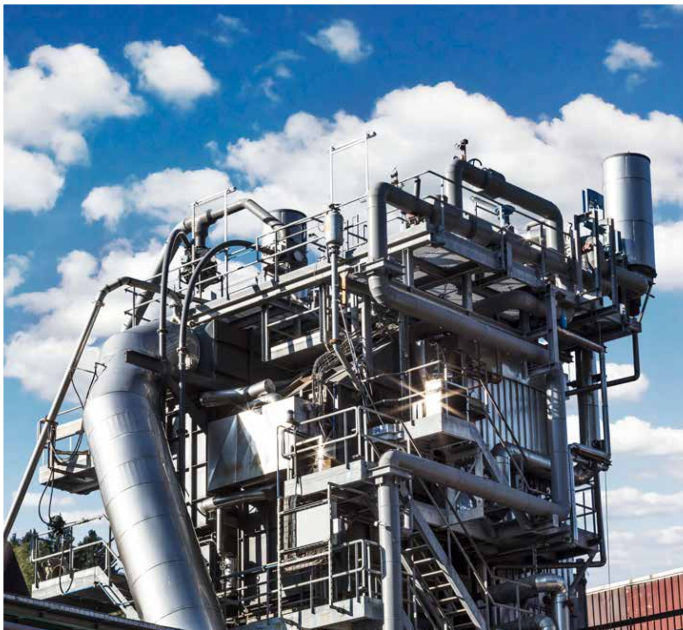
Impianto di Recuper del Calore (IRC)
